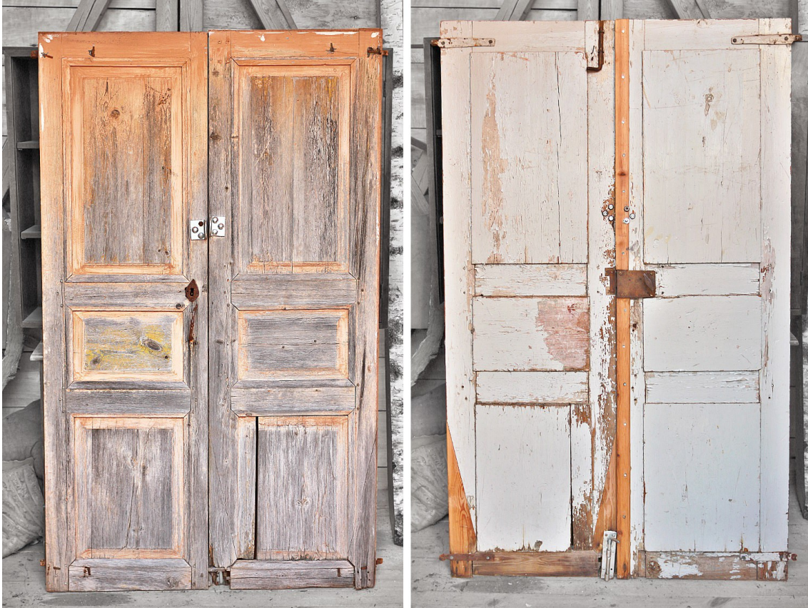
Kuva 7: Palolan tuvan ovet ulko- ja sisäpuolelta ennen kunnostusta.
