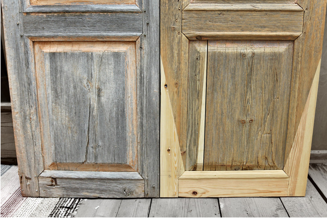
Kuva 20: Ovi kasattuna edestä. Liitoksen lukitsevat puutapit puuttuvat vielä korjauskohdasta. Lopullinen kasaus tapahtui vasta pohjamaalauksen jälkeen, jotta helposti kosteudesta vaurioituva alakynte sekä alapeilin alapää voitiin myös maalata. Alapeilin sauma jätettiin tietoisesti hieman harvaksi, jotta turpoavasta peilistä ei koituisi ongelmia, kun ovi viedään verstaalta takaisin normaaliolosuhteisiin. Kuvassa oikeanpuoleisesta ovesta on jo hiottu harmaantunutta puuta, kun vasemmanpuoleinen on vielä käsittelemätön.
