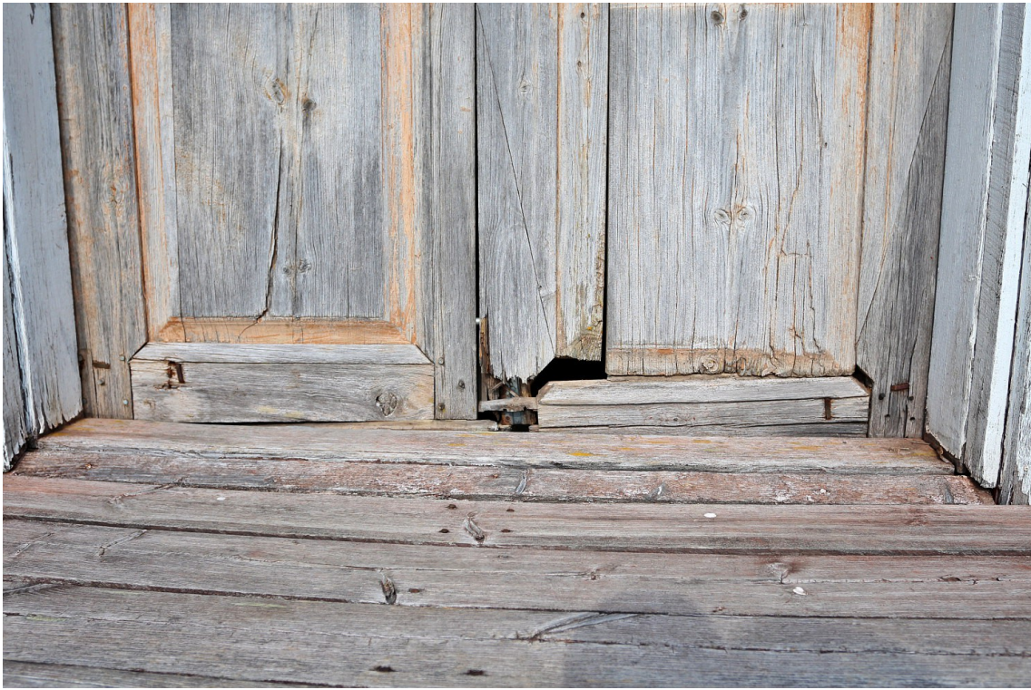
Kuva 16: Ovien maalipinnat ovat hyvin kuluneet, ja säät ovat alkaneet vaurioittaa puuainesta. Mikäli ovien maalaus olisi uusittu aiemmin, olisi puukorjaukselta voitu välttyä. Toinen ovipuolisko on vielä jokseenkin ehjä.
