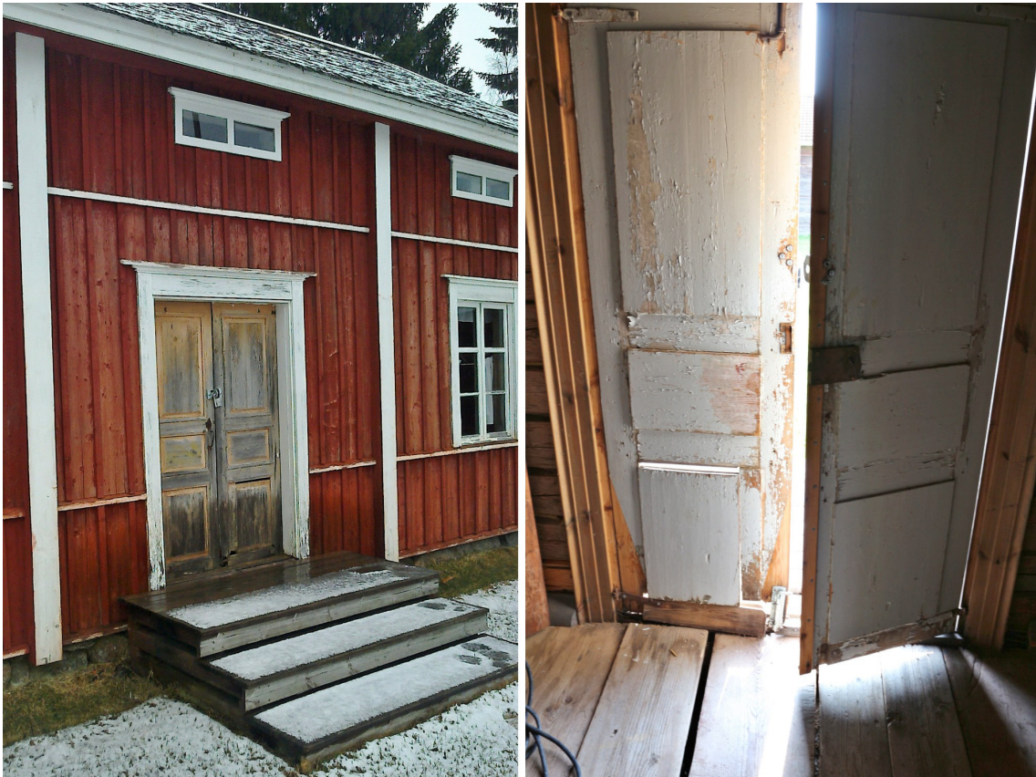
Kuva 15: Ovet ennen korjausta. Parioven ulkoa katsottuna oikeanpuoleisen puoliskon kehys on lahonnut alaosaan niin, että oven alapeili on pudonnut paikoiltaan. Ovi ei enää kestä avaamista. Lahoamisen syy näyttää vasemmanpuoleisessa räntäsadepäivänä otetussa kuvassa ilmiselvältä: katolta ja taivaalta tuleva vesi roiskuu korkealla olevasta portaasta kastellen oven alimman peilin lähes kokonaan. Tilannetta parantamaan tulisi räystäälle laittaa kouru tai oven päälle katos. Myös portaan madaltamisesta olisi hyötyä. Sisäpuolen kuvasta erottuu hyvin, miten oven alaosaan on uusittu puuta jo aiemmin. Tämä on tapahtunut todennäköisimmin 1980-luvun lopulla, kun rakennusta on siirretty nykyiselle paikalleen.
